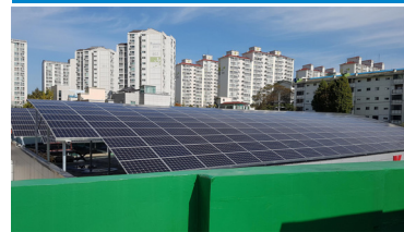
K태양광 발전소 (99kW)
