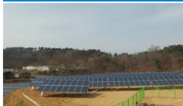
목과 태양광발전소 (282,72kW)
